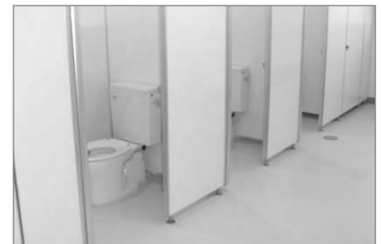
<トイレの洋式化事例>
